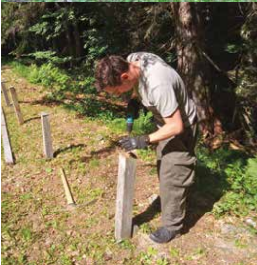
Nach dem Winter zeigten sich beim Bergfriedhof Angerbachtal/IR 7/III Schäden an der Umzäunung, die nun behoben wurden.
